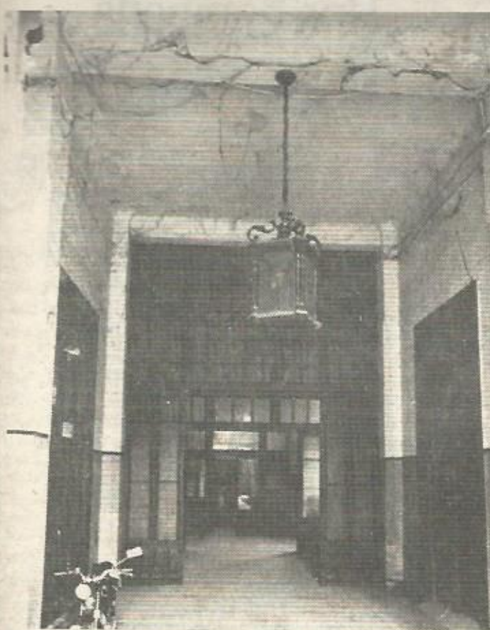
Entrada principal al Instituto Mixto Núm. 5 de la capital aragonesa. Puede observarse el estado de abandono a través de las enormes telarañas
