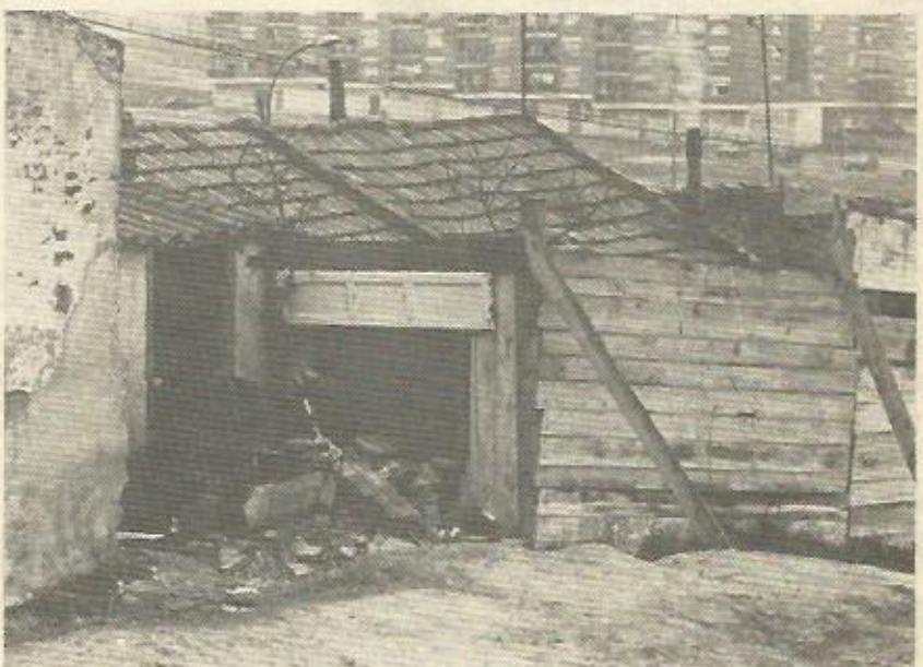
Una chabola que tiene que ser apuntalada. Y sin embargo, está habitada.
