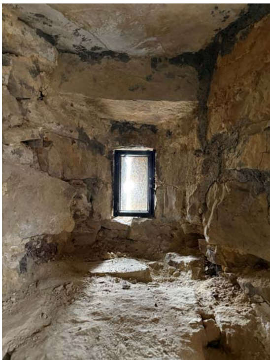
Châssis de meurtrière posé dans une baie profonde.
