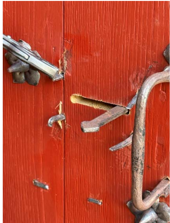
Détail des reprises sur la porte nord.
