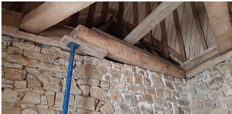
Vue sur la sablière dans les combles de la tour ronde. Un étaie provisoire a été posé.
