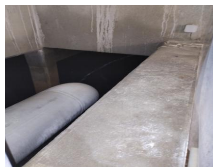
Gérige - Cuve 200 m3 sans accès
