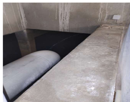
Gériage - Cuve 200 m3 sans accès
