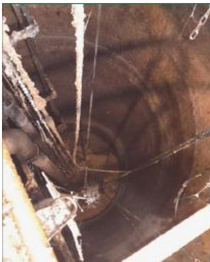
BOURG SAINT ANDEOL – Poste de relevage Souteyranne
